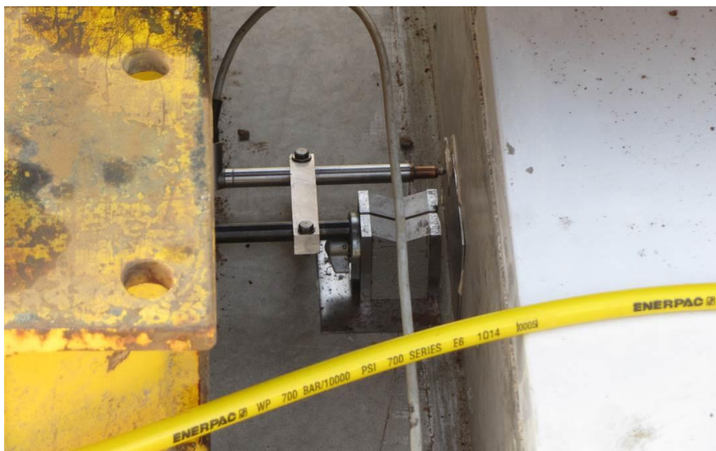
Obrázek 5 – Sledování otevření trhliny na konzole indukčním úchylkoměrem
