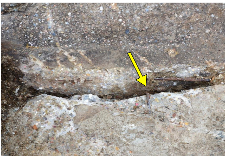
Obr. 3.: Mohutná trhлина v betonu, přetrhnutí výztuže ve vnitřní patě pravé stěny (šipka) [1]
