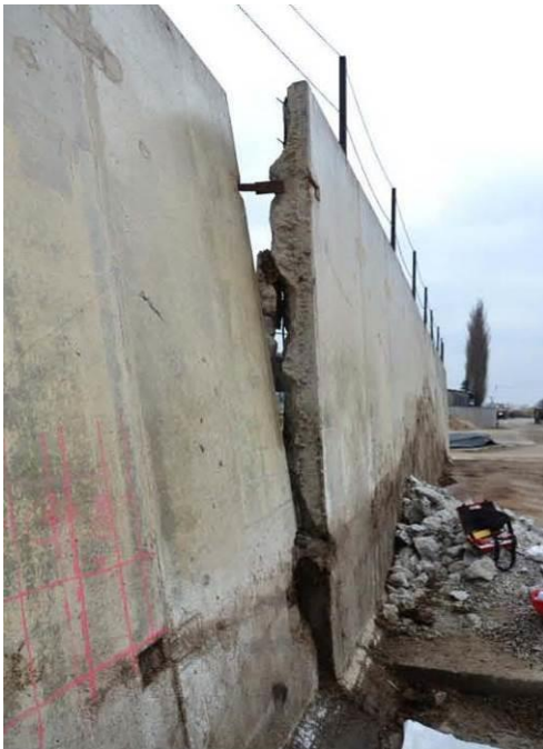
Obr. 1.: Vyklonění krajní zdi, destrukce betonu, sonda u paty zdi [1]
