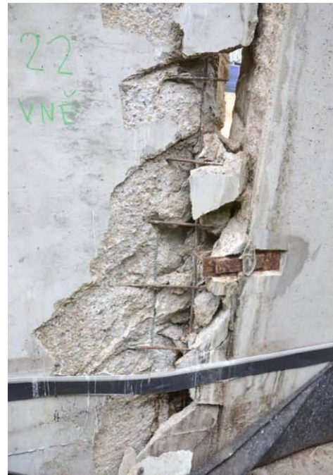
Obr. 2.: Obnažená výtzuž zdi ve spoji dílců, poruchy spojovacích plechů [1]
